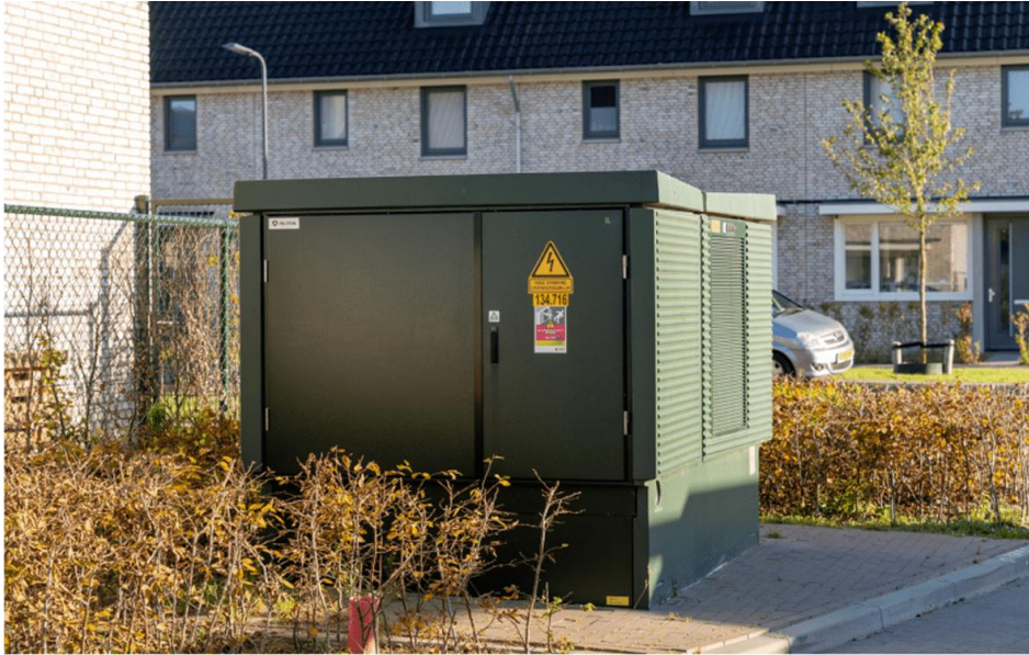
Figuur 25 – Voorbeeld van een MSR of elektriciteitshuisje in het straatbeeld
