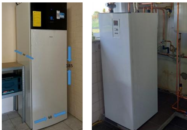
Figuur 18 – Twee voorbeelden van een binnenunit en boilervat van een individuele warmtepomp
